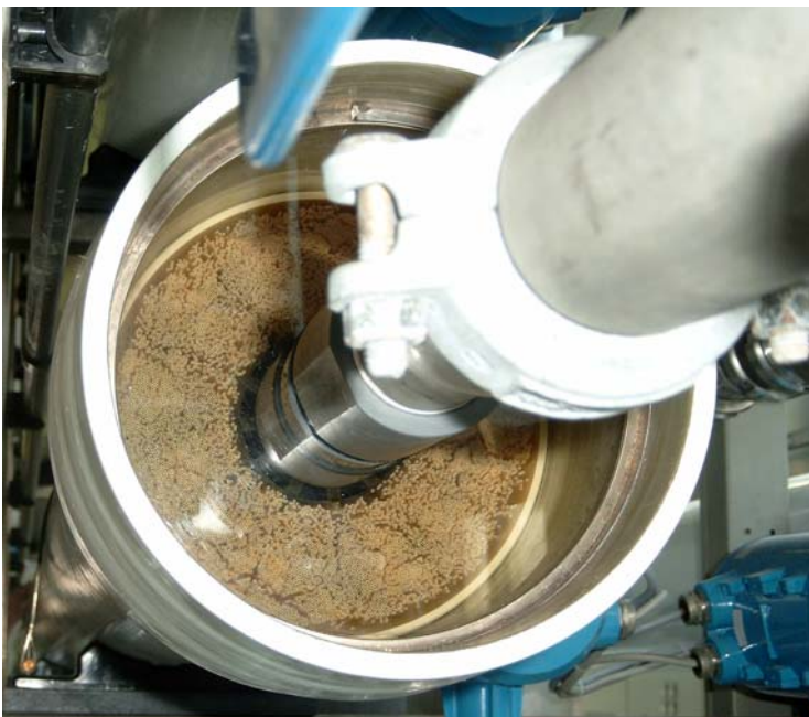
Figur 14.4. Ultrafiltreringsanlæg med hulfibermembraner til behandling af svømmebadsvand
